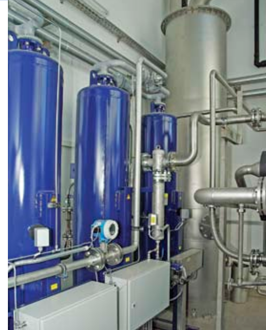
Kombinierte Reinigungs- und Trocknungsanlage für CO 2 (links) Edelstahl-Rohgaswäscher (rechts)
